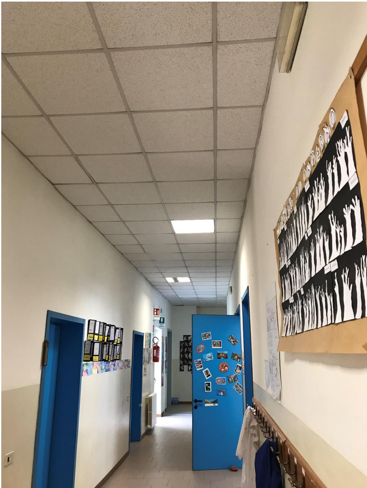
Figura 14: Vista del corridoio piano primo con il giunto sismico presente sullo sfondo
