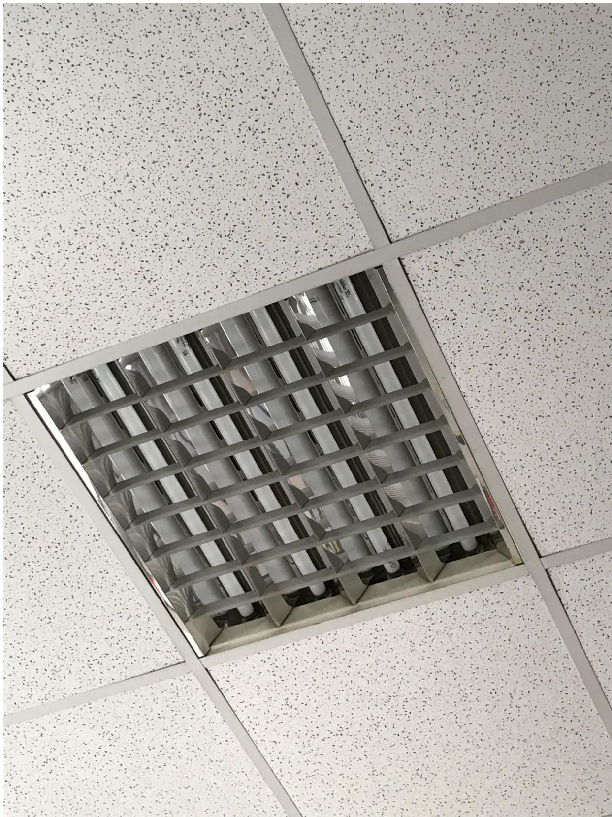
Figura 17: Particolare della plafoniera a tubi fluorescenti presente nelle aule
