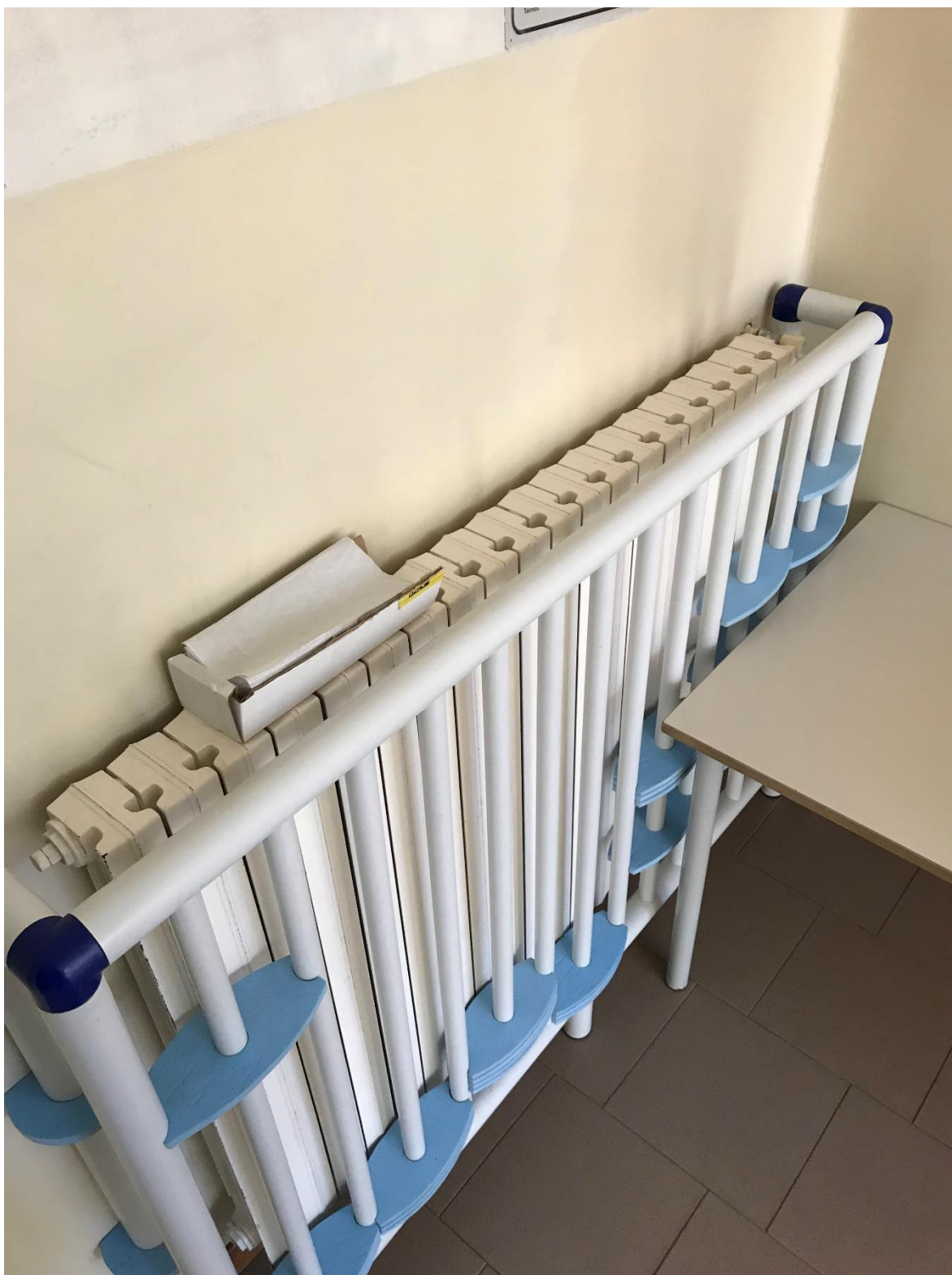
Figura 11: Particolare dei termosifoni presenti all'ingresso
